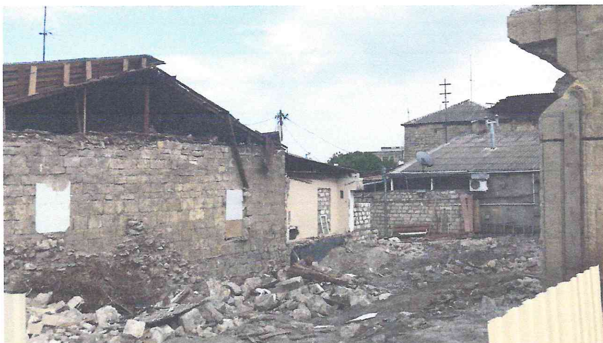
Фото №2. Объект строительства по адресу: г.Дербент, пл.Свободы, дом №5, в зоне регулируемой застройки, регламентная территория с режимом «РЗ» (приказ Минкультуры России от 18.12.2015г. №3133).
