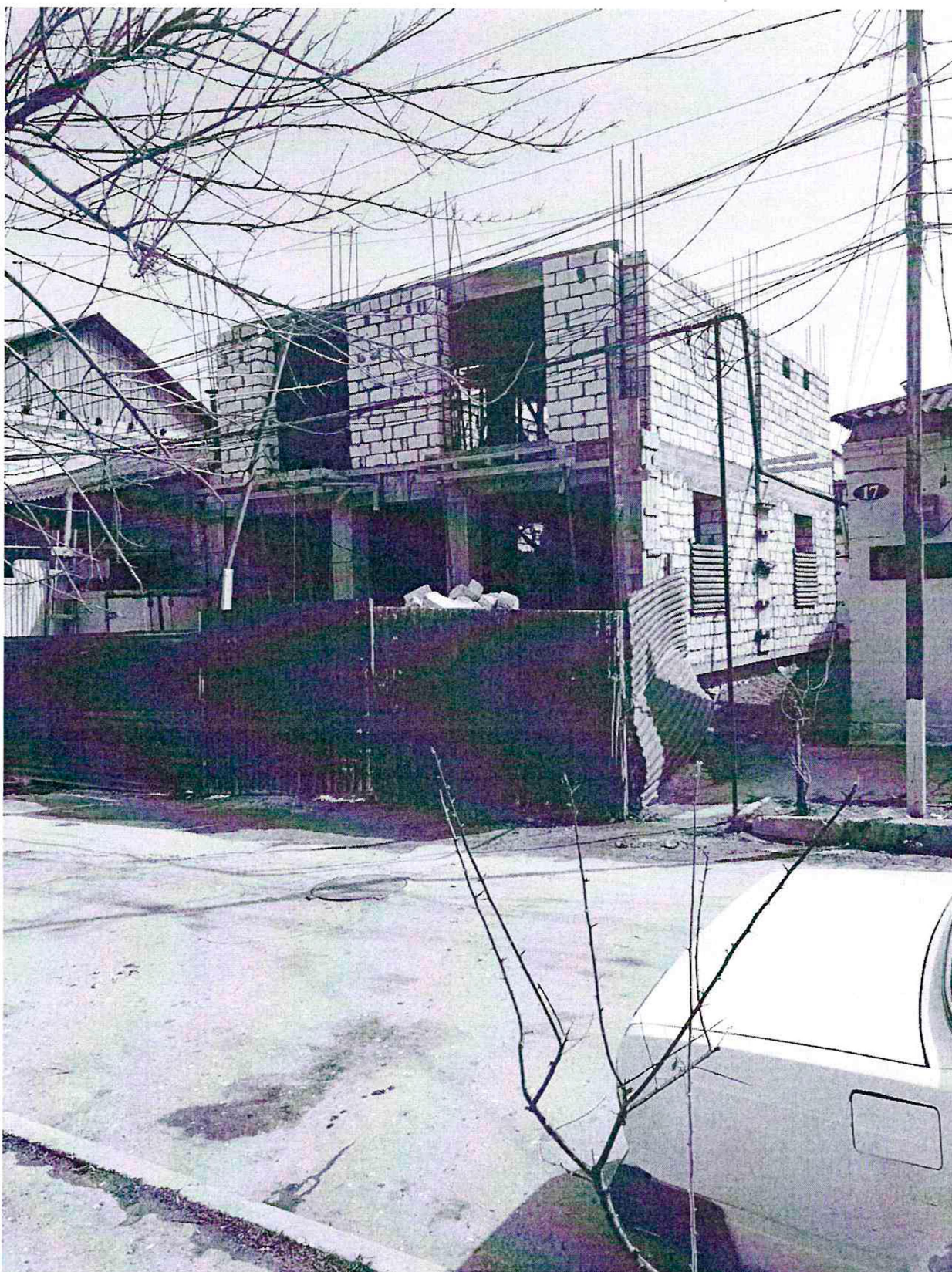
Фото №1. Не согласованные строительные работы на земельном участке по адресу: г.Дербент ул. Кандаки, 17
