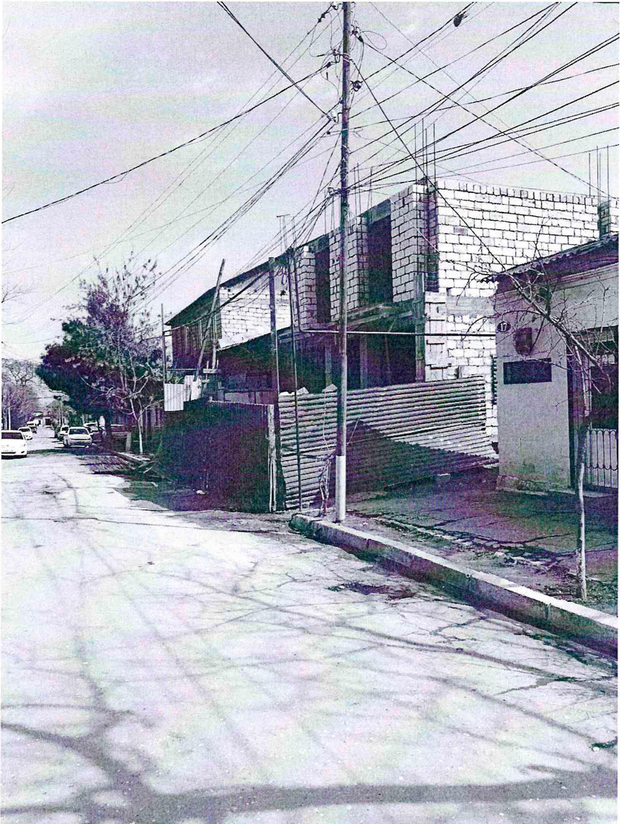
Фото №2. Не согласованные строительные работы на земельном участке по адресу: г.Дербент ул. Канделаки, 17.
